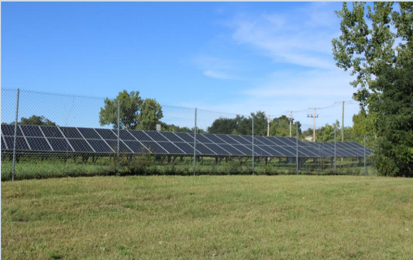
Instalación solar en Oak Street
